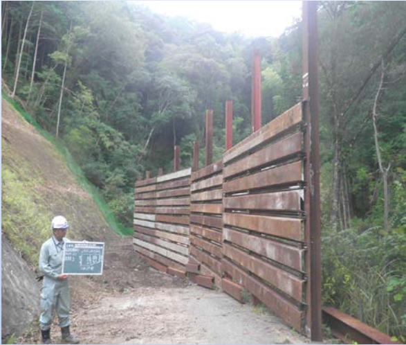
① 鋼製の土留は落石の衝撃に対応
