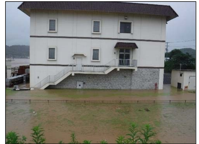
約1.4m浸水（三原市本郷第2ポンプ場）
