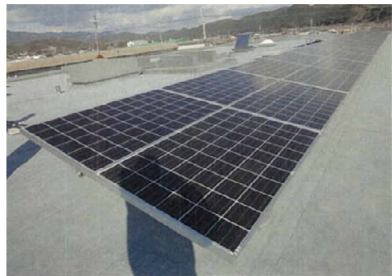
中央東福祉保健所に設置された太陽光発電パネル
