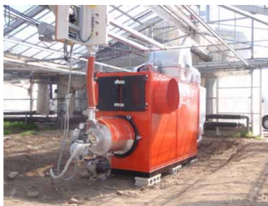
木質ペレットボイラー (南国市長岡)
