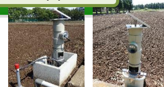
自動・遠隔水管理システム
