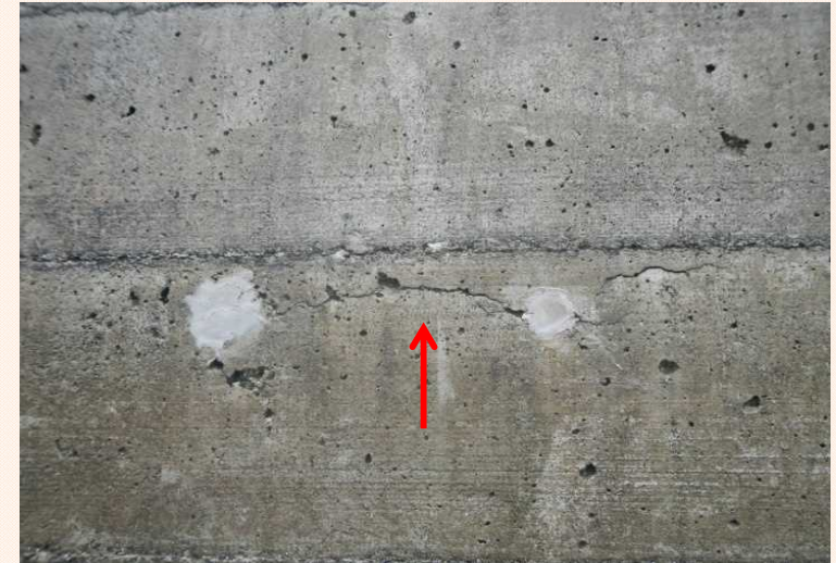
セパレータのコーン跡下方の沈下ひび割れ
