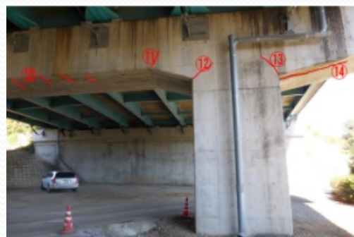
FD-15未混入コンクリートのひび割れ例
