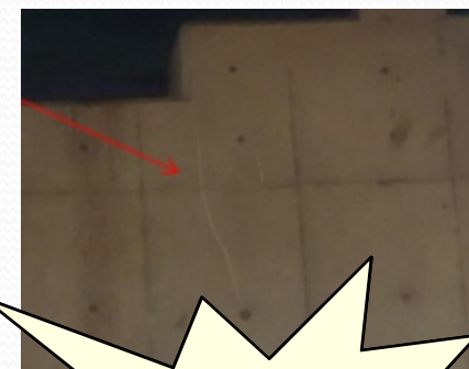
FD-15混入コンクリートのひび割れ例
