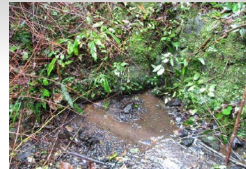
堤体下流部。漏水が見られる。
