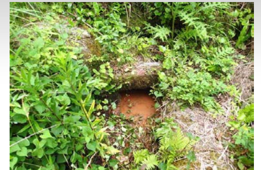
旧底樋。現在使用不可であり漏水も見られる。
