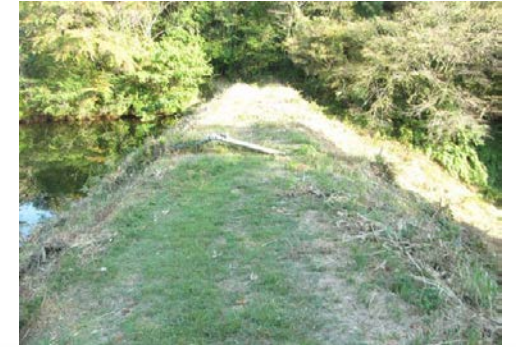
ため池の堤体。幅員は2m程度であり老朽化している。
