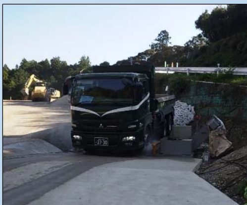
【タイヤ洗浄機：残土場】
