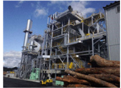
高知県内のバイオマス発電所
