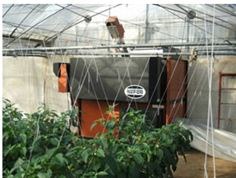
木質バイオマスボイラーの導入事例
