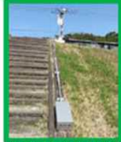
危機管理型水位計の設置
