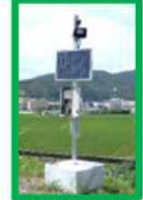
監視カメラの設置
