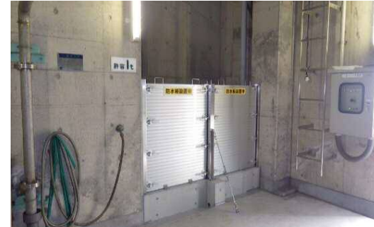
建物内への浸水防止策 (左：防水扉 右：止水板)
