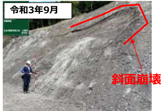
1:1.0勾配斜面 施工中の崩壊状況
