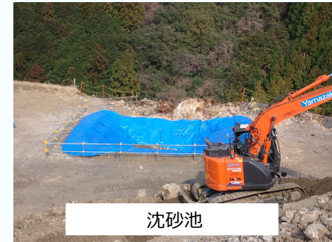
濁水処理設備
