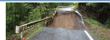
<被災した道路>
