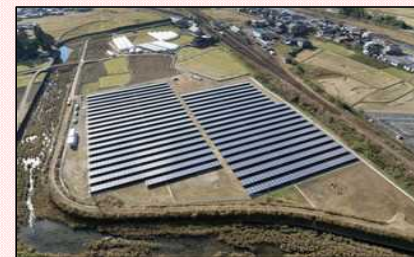
県内の太陽光発電施設
