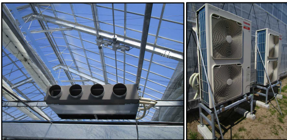
施設園芸へのヒートポンプ導入の様子
