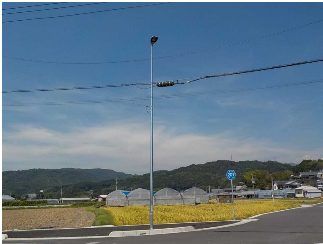
道路照明設置 N=8基
