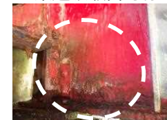
新大森橋の損傷状況
