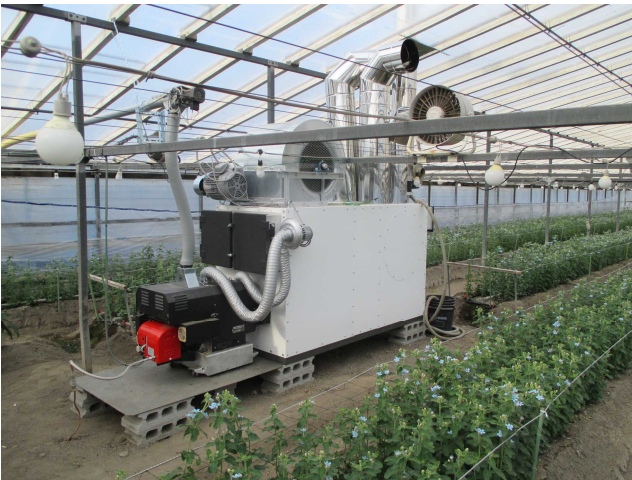
木質ペレットボイラー (芸西村)
