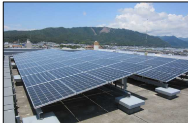
県安芸総合庁舎屋上に設置した太陽光発電設備
