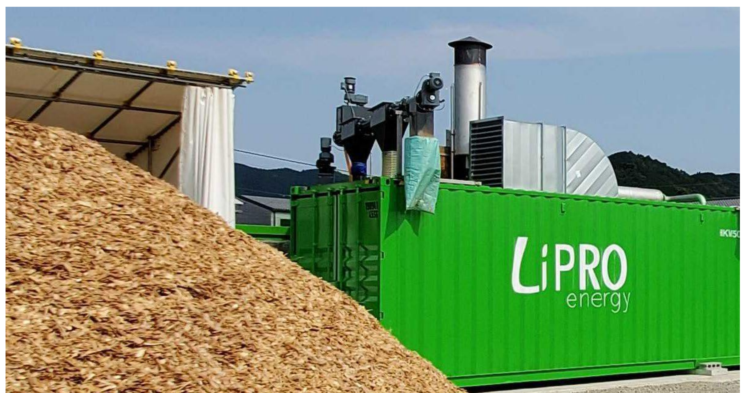
CHPで使用する木質チップ
