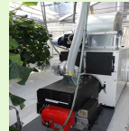
木質ペレットボイラー
