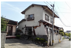
〔熊本地震での住宅被害〕
