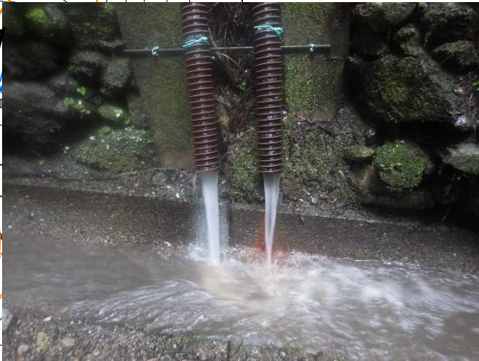
A上部ブロック横ボーリング排水状況 最大160リットル/分（8本合計）
