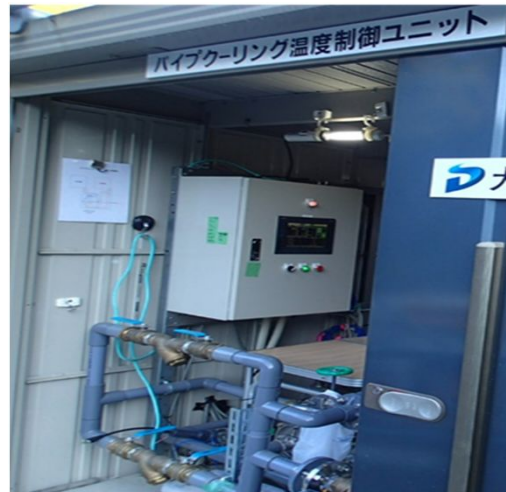
自動温度制御ユニット
