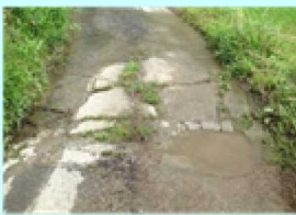
老朽化した農道
