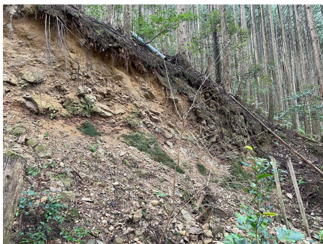
頭部段差亀裂の状況
