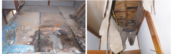
雨漏りにより畳も天井もボロボロに……
