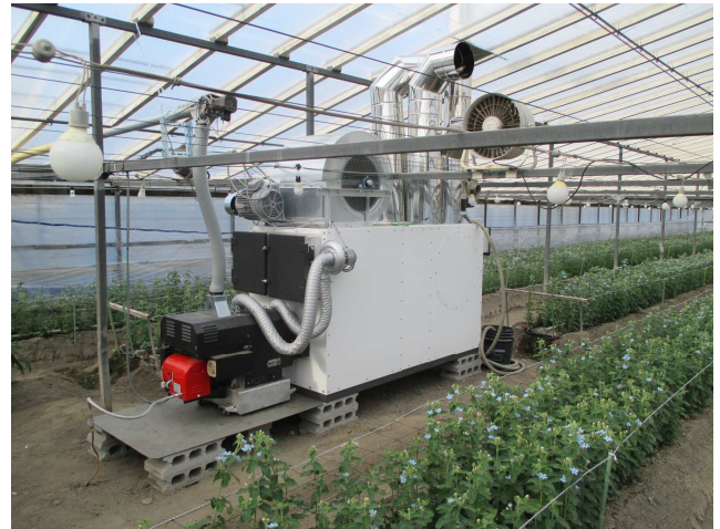
木質ペレットボイラー（芸西村）
