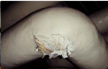
エルボ部に使用 石綿含有保温材
