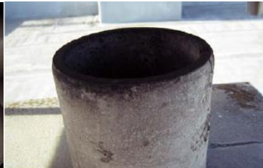
煙突の内側に使用 石綿含有断熱材
