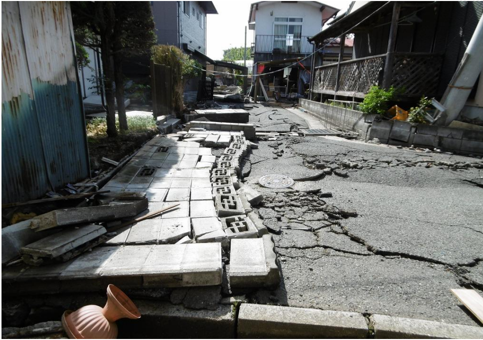
熊本地震の被害事例
