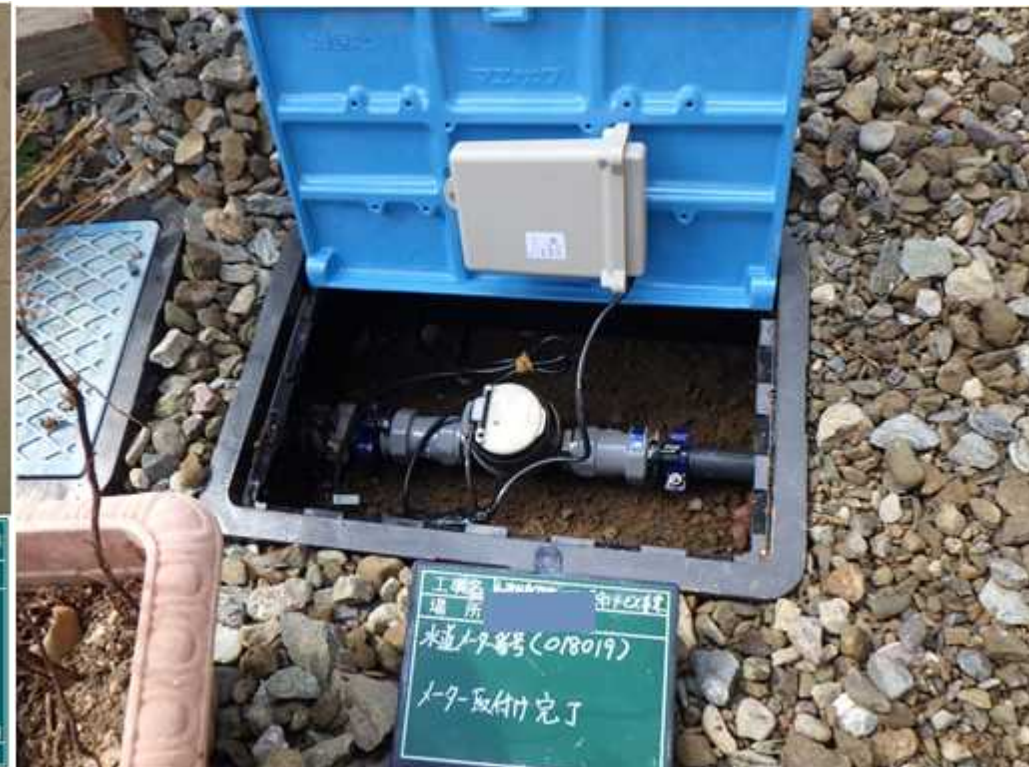
(実証対象世帯に設置した電子式水道メーターと通信装置)
