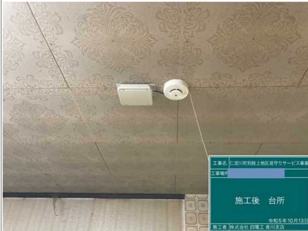
(実証対象世帯に設置した火災警報器と通信装置)
