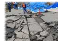
水道管損傷→（能登町）
