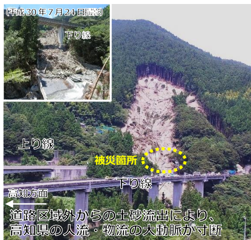
【高知自動車道の被災状況】
