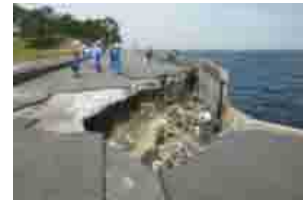
横浜港金沢地区の護岸被災（令和元年T15号） 写真：港湾等に来襲する想定を超えた高潮・高波・暴風対策検討委員会最終とりまとめ概要（R2.5.29）
