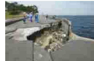
横浜港金沢地区の護岸被災（令和元年T15号）
