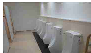
壁掛小便器の採用
