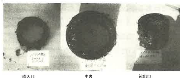
図5.2 導水管内の付着物
