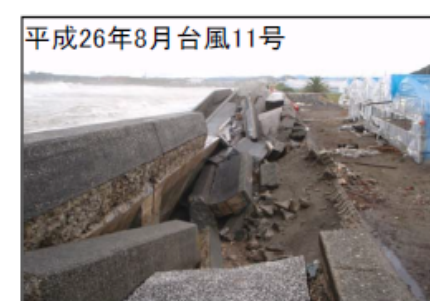
被災状況 (南国市)
