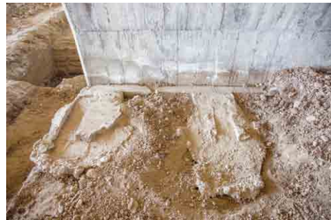
10cm程度埋まっていた後部アーチのコンクリートの基礎台
