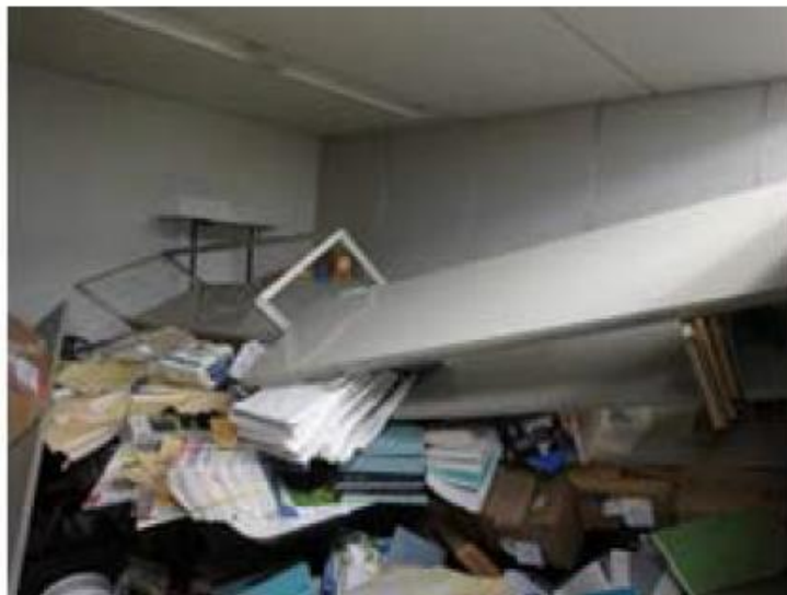
2011年東北地方太平洋沖地震 高層階における本棚の転倒（24階の被害）
