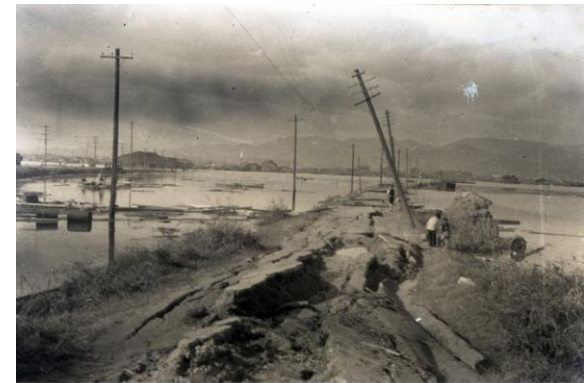
2. 21.12.22 葛島橋より昭和国民学校に至る道路 道路の亀裂. 堤防欠壊による浸水を見る.
