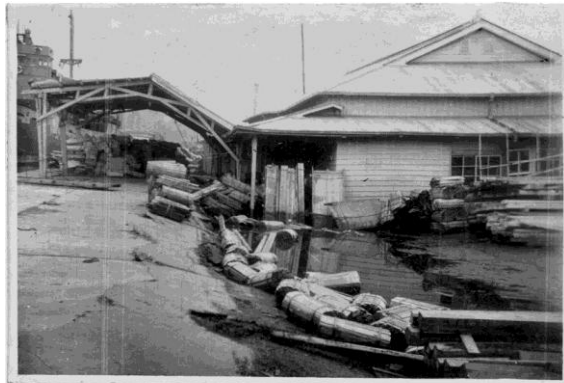
27. (21.12.26) 地盤の沈下と家屋の傾斜. 2日間沈下 高知市棧橋土佐商船乗船場 (埋立地)
