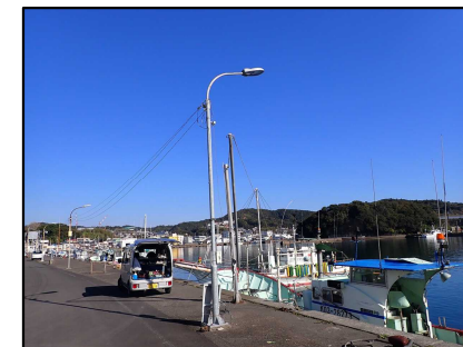
漁港施設照明の省エネ化
