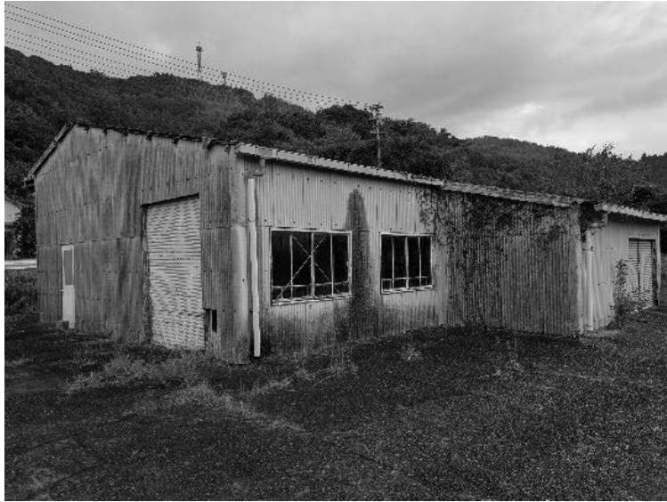
【建物老朽化④】
