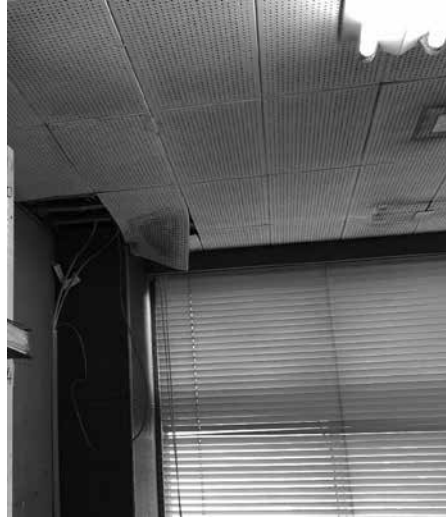
【内部の書類保管の様子3（天井が崩落している箇所）】
