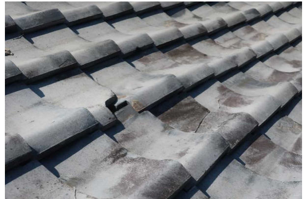
写真 2.1.15 瓦の割れ・欠け
