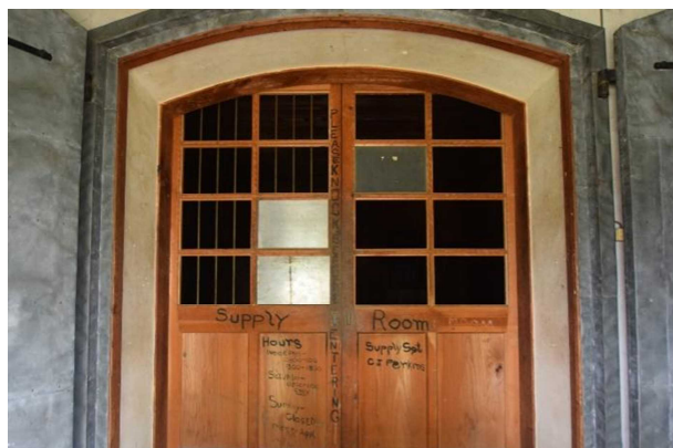
写真 2.1.21 腰板ガラス戸 真鍮製格子の欠失・ガラスの割れ
