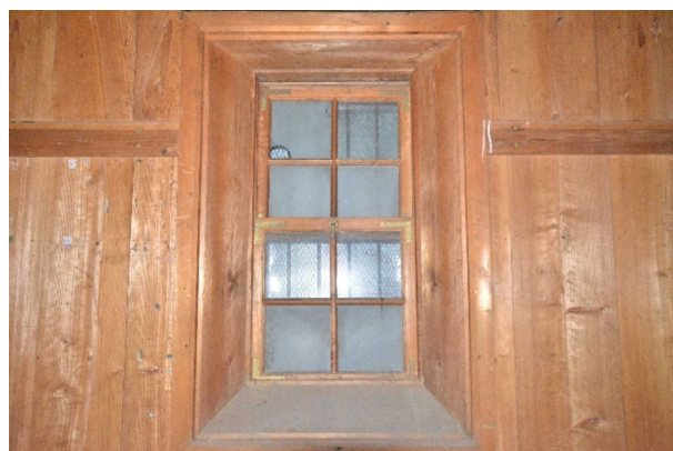
写真 2.1.22 上げ下げ窓 ガラスの割れ
