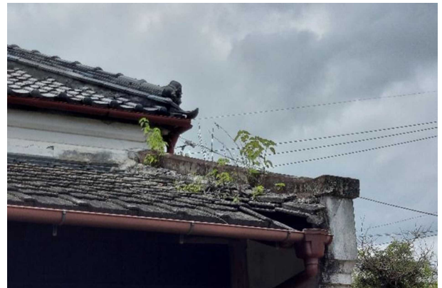
写真 2.1.16 セメント瓦の崩れ
