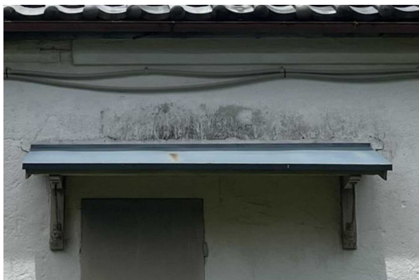
写真 2.1.18 外壁開口部廻りの庇の発錆
