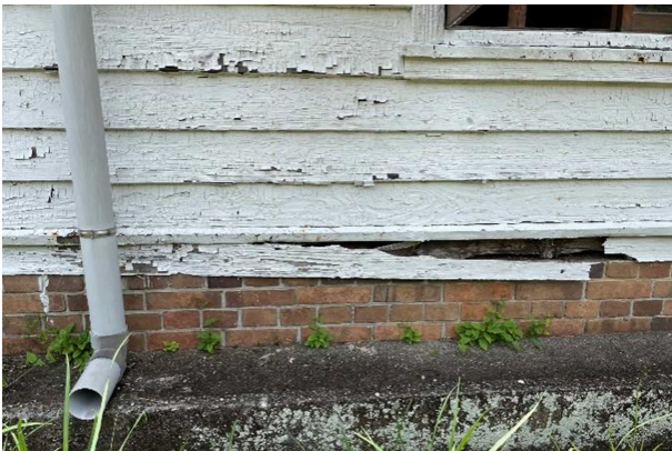
写真 2.1.28 土台の破損・腐朽
