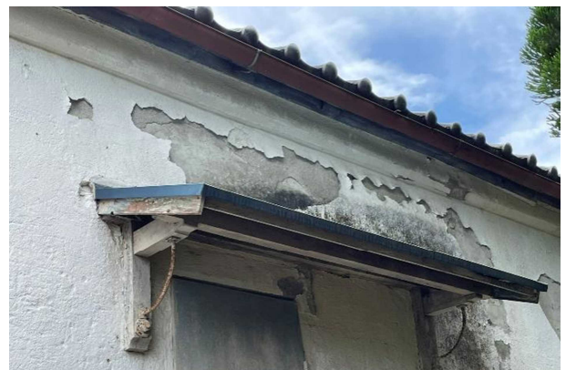
写真 2.1.4 モルタルの剥落
