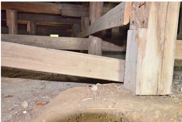
写真 2.1.1 根がらみの外れ
