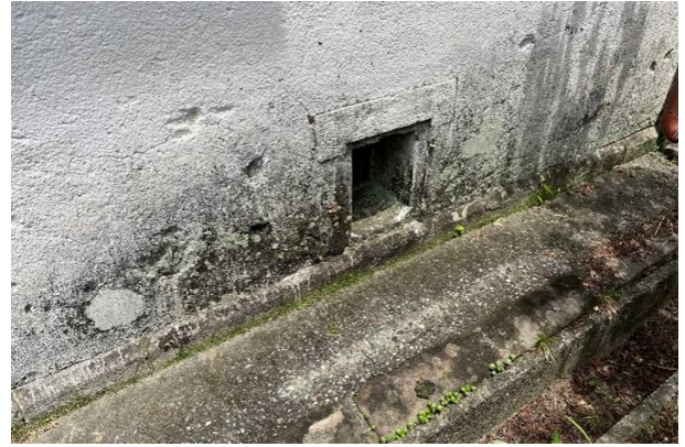
写真 2.1.25 犬走の割裂、植物の発生
