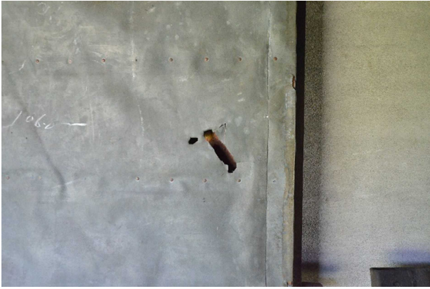
写真 2.1.23 鋼製扉 塗膜の浮き・剥離
