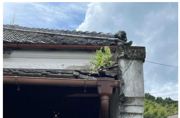
写真 2.1.17 じょうごや呼び樋の汚れ
