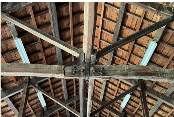
写真 2.1.29 下弦材 継手の緩み
