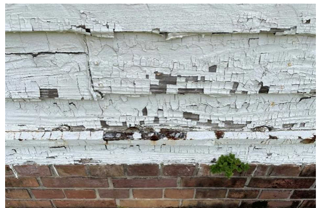
写真 2.1.26 下見板張り 塗装の劣化
