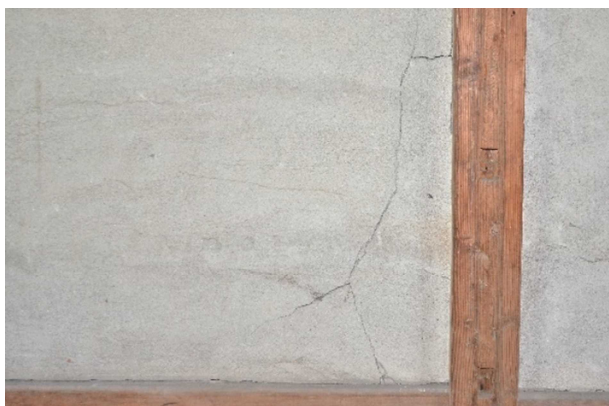
写真 2.1.19 砂漆喰の亀裂
