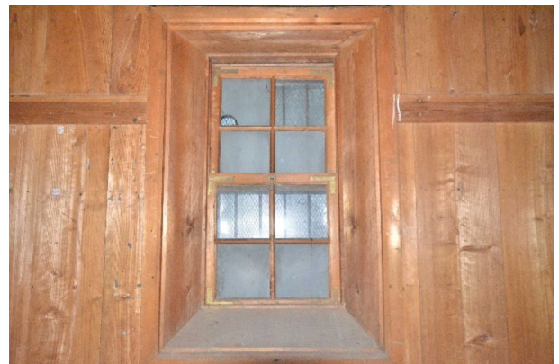
写真 2.1.22 上げ下げ窓 ガラスの割れ
