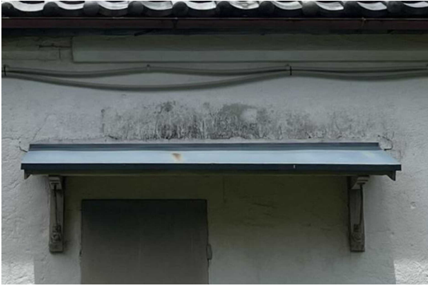
写真 2.1.18 外壁開口部廻りの庇の発錆
