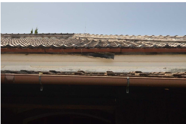
写真 2.1.8 軒蛇腹の欠失・破損
