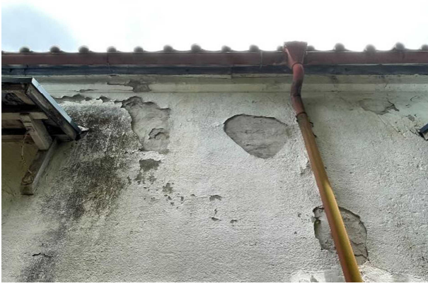
写真 2.1.5 縦樋付近の汚損
