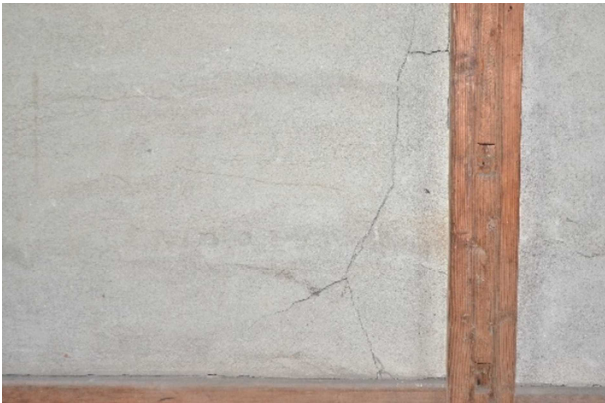
写真 2.1.19 砂漆喰の亀裂
