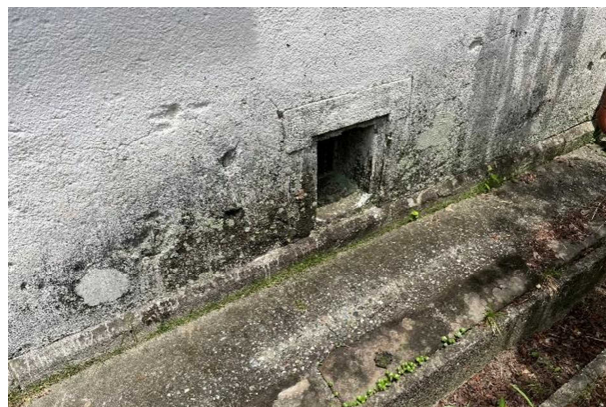
写真 2.1.25 犬走の割裂、植物の発生
