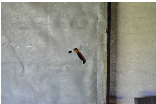
写真 2.1.23 鋼製扉 塗膜の浮き・剥離
