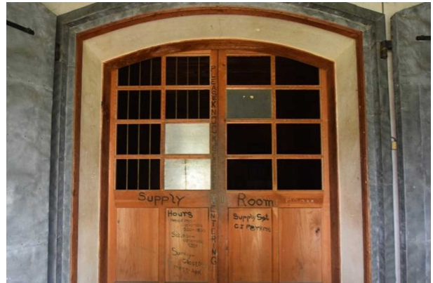
写真 2.1.21 腰板ガラス戸 真鍮製格子の欠失・ガラスの割れ
