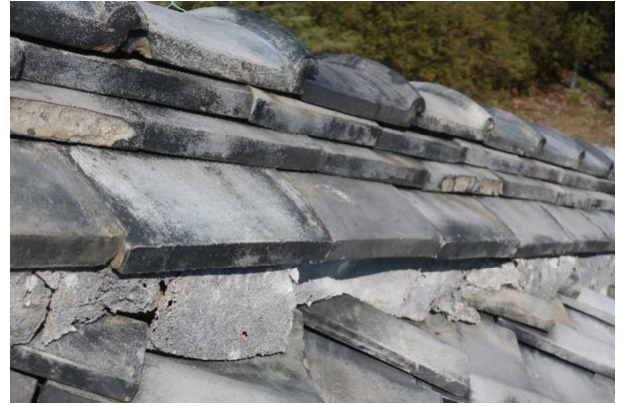
写真 2.1.14 棟積みの南蛮漆喰の亀裂・剥落
