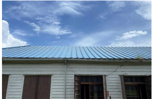
写真 2.1.30 屋根の歪み、鉄板の発錆
