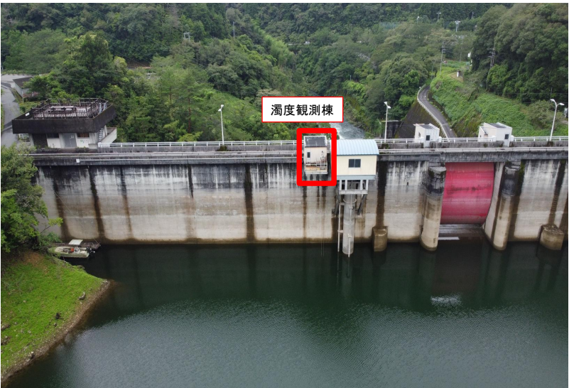
▲自動濁度計 全景
