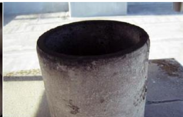
煙突の内側に使用 石綿含有断熱材
