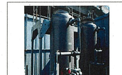
⑦地下水保全対策 有機塩素系化学物質により汚染された地下水を施設の装置に通すことにより水質浄化を図った。(秦野市)
