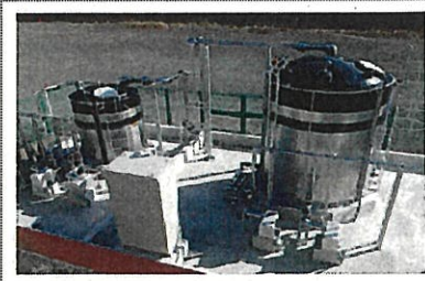
⑨相模川水系上流域対策 山梨県内の下水処理場に新たに設置したリンを取り除くための設備を稼動した。(山梨県 桂川清流センター)
