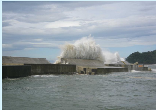
防波堤状況(台風による越波)
