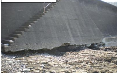
堤体からの漏水
