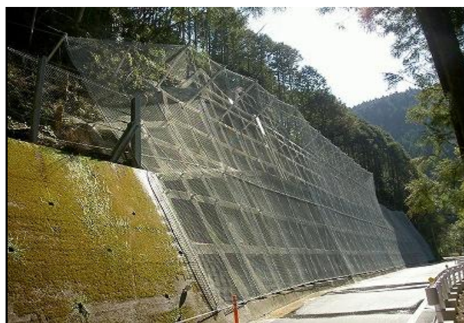
道交地自主(1.5車)第11-056-2号 県道畑山栃ノ木線地域自主戦略交付金工事
